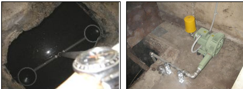
그림 2 링블로워 방식의 공기공급장치 설치
