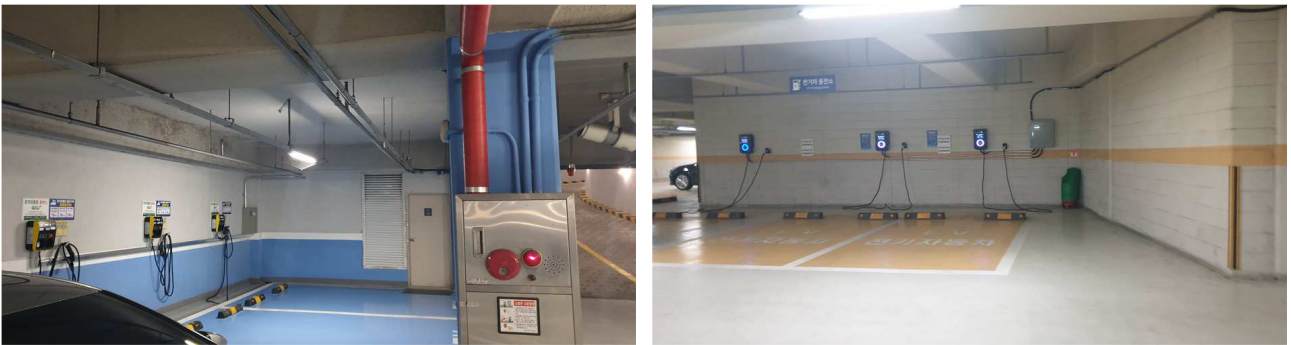
<그림 35> 화재감지기가 설치되지 않은 전기차 충전구역
