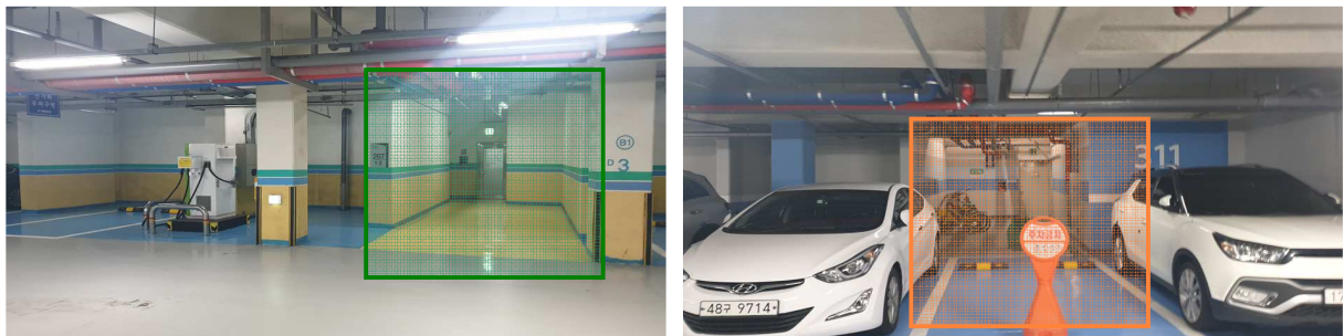
<그림 28> 주동 출입구 옆에 설치된 충전구역(좌), 주동 출입구 앞에 위치한 주차공간(우)
