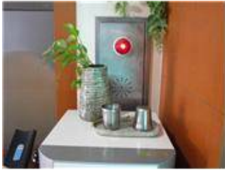
▲ 적재물로 인하여 소방시설의 사용이 제한되는 경우
