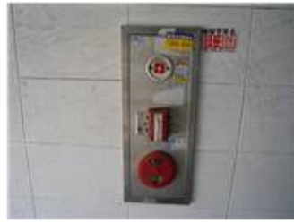
▲ 위치표시등의 파손을 방지한 경우
