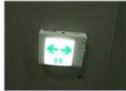
▲ 통로유도등이 올바르게 설치된 경우
