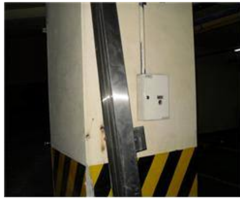
▲ 방화셔터 레일이 파손된 상태로 방치한 경우
