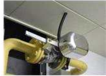
▲ 가스누설경보기의 차단밸브가 설치된 사례
