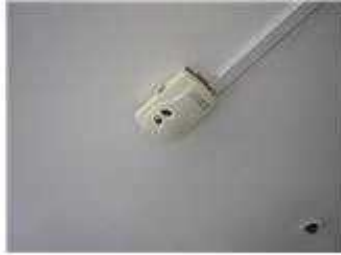
▲ 가스누설경보기의 탐지부가 설치된 사례
