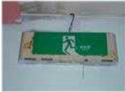
▲ 유도등이 부식되어 점등되지 않는 경우
