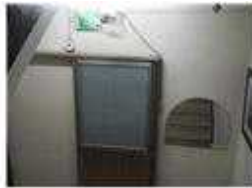
▲ 장애물로 인한 유도등의 식별이 제한되는 경우
