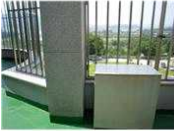
▲ 구조대 설치장소에 창살과 시건 장치로 사용이 제한되는 경우
